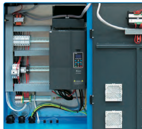
Quadro elettrico e inverter.
