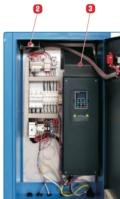
Quadro elettrico e inverter.
