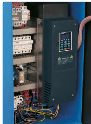
Quadro elettrico e inverter.
